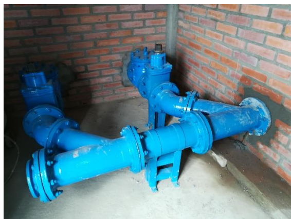
Estación 1 del Alcantarillado – Centro Poblado de Puerto Jordán
