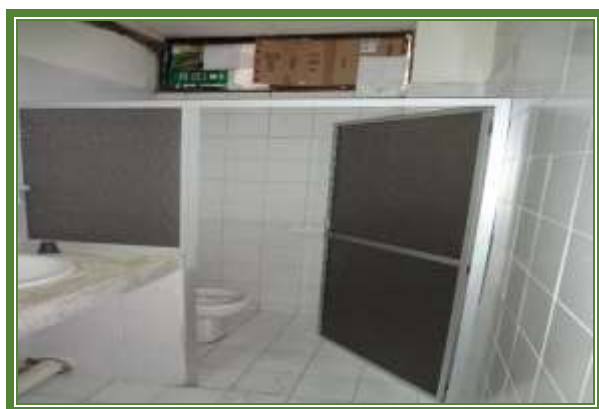
Condiciones anteriores baño
